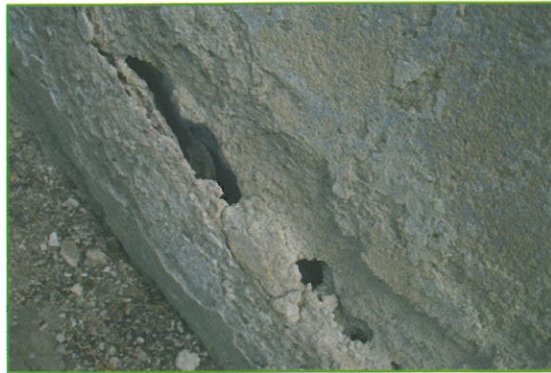
Σκασμένα εξωτερικά επίχρισματα των τοίχων
