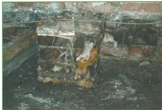
Ανάπτυξη μούχλας, μυκήτων και πρόκληση ζημιών στο δομικό υπόβαθρο
