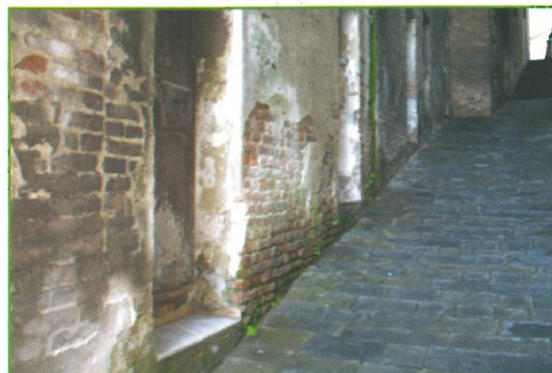
Καταστροφή του εξωτερικού επίχρισματος και των αρμών της τοιχοποιίας
